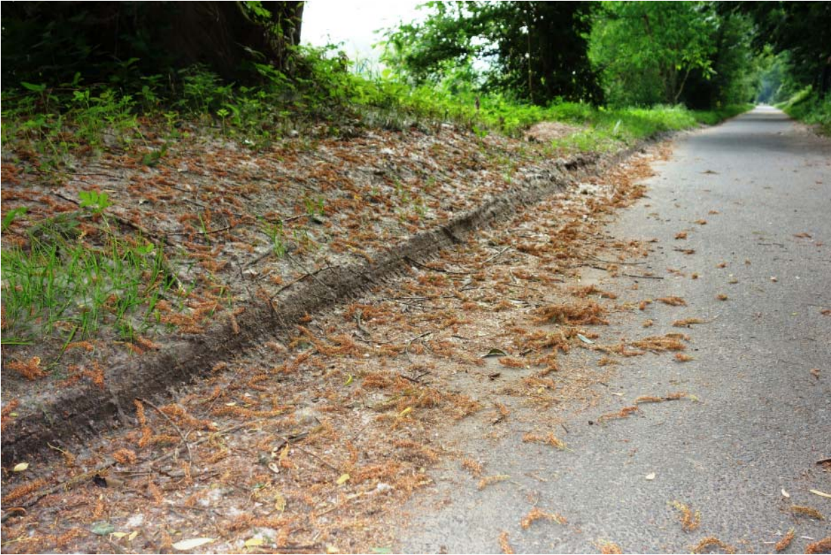
Radweg R3: teilweise stark verschmutzt
