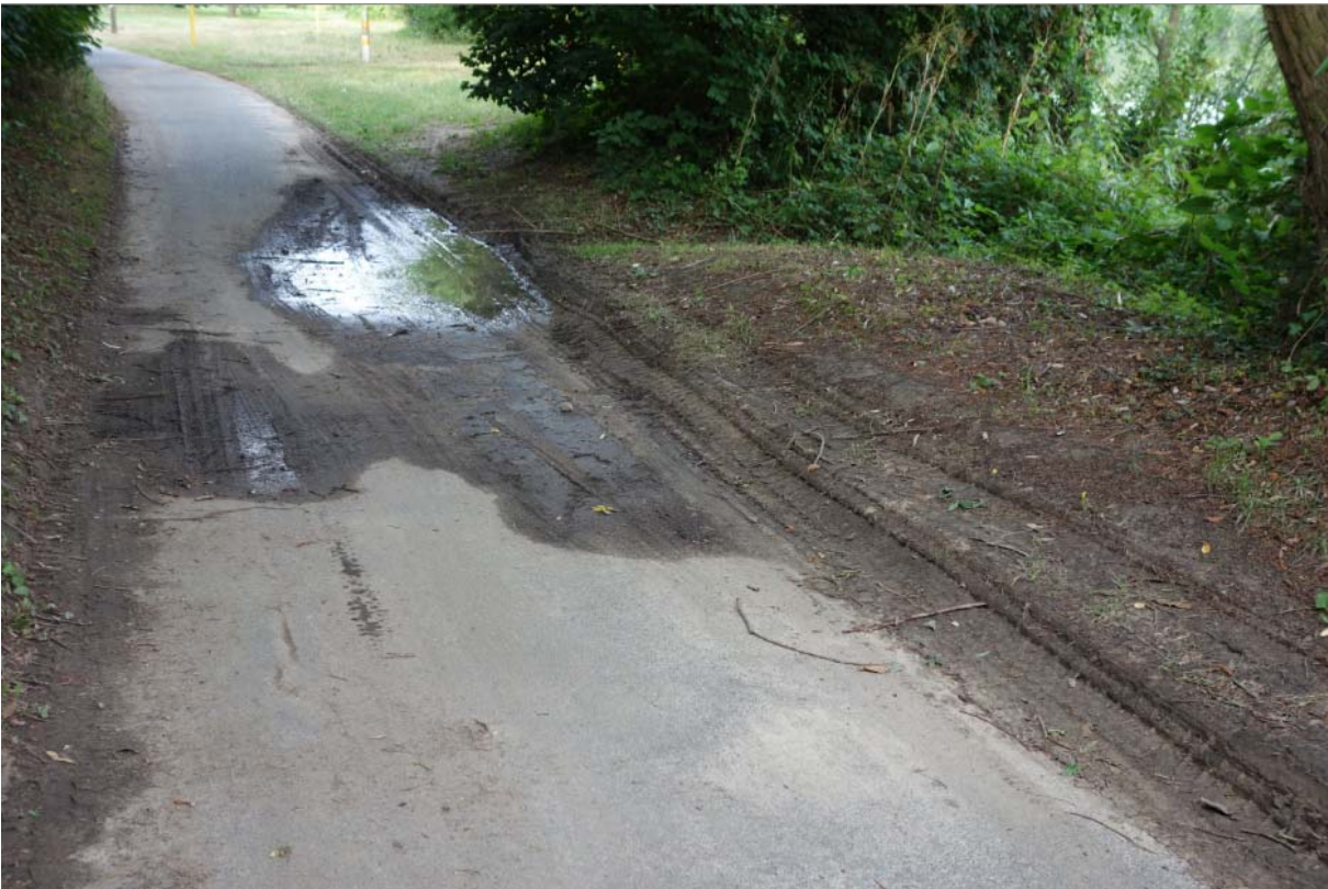
Radweg R3: teilweise stark verschmutzt
